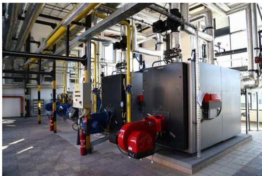
Obr. 6 Pohľad do zrekonštruovanej teplovodnej kotolne na zemný plyn
