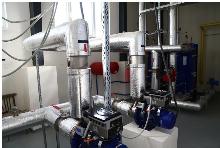
Obr. 5 Pohľad na doskové výmenníky tepla VT1 a VT2 v popredí obehové čerpadlá
