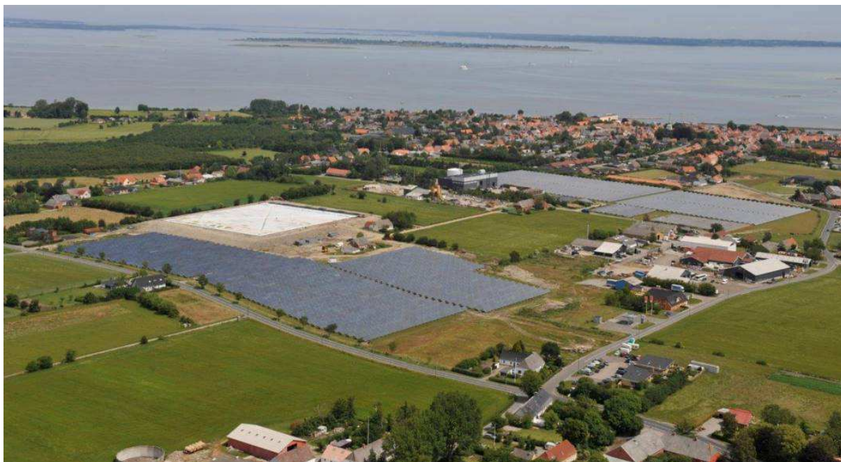
Obr. 13 Najväčšia komunálna inštalácia v Európe – 33 000 m 2 kolektorov, 75 000 m 3 v zásobníku. Zdroj : internet
