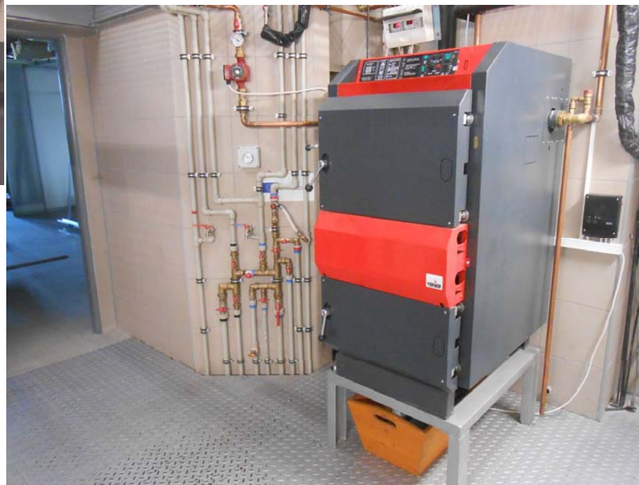
Kotel v přízemí
